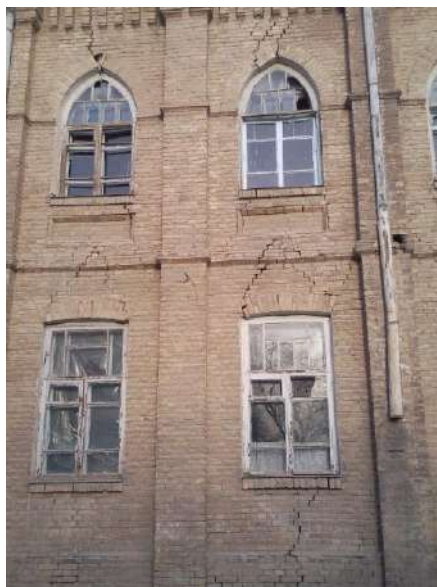
Рис. 10. Фрагмент западной торцевой стены здания; имеются опасные осадочные трещины, рекомендуется выполнить реставрацию кладки историческими материалами
