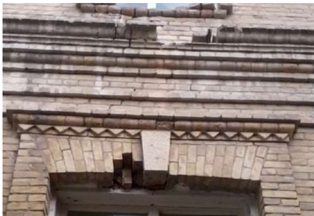
Рис. 5. Фрагмент стены здания из орнаментальной кладки с значительными трещинами, требующими реставрацию историческими материалами
