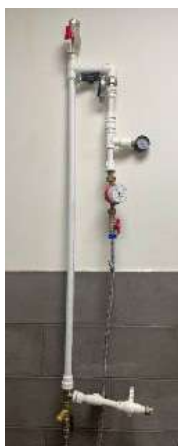
Рис. 3. Внешний вид фильтрующей установки
