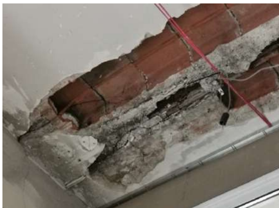
Рис. 5. Частичное оголение арматуры
