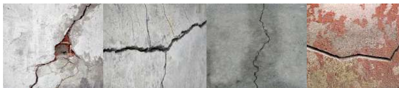
Рис. 4. Фото конструкций с трещинами
