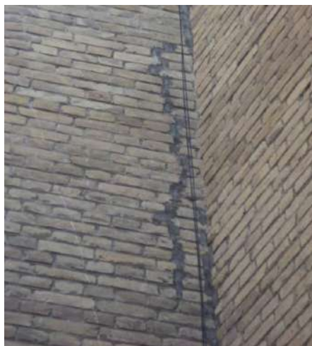
Рис. 8. Заделка трещины цементным раствором, снижающим архитектурную ценность здания
