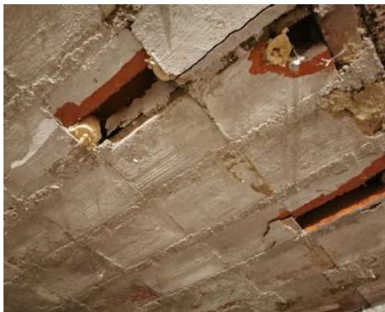
Рис. 3. Разрушение отдельных керамоблоков перекрытия
